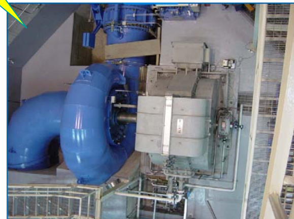
Planta en servicio 8 MW Ahorros de 10 al 35 % de CFE
