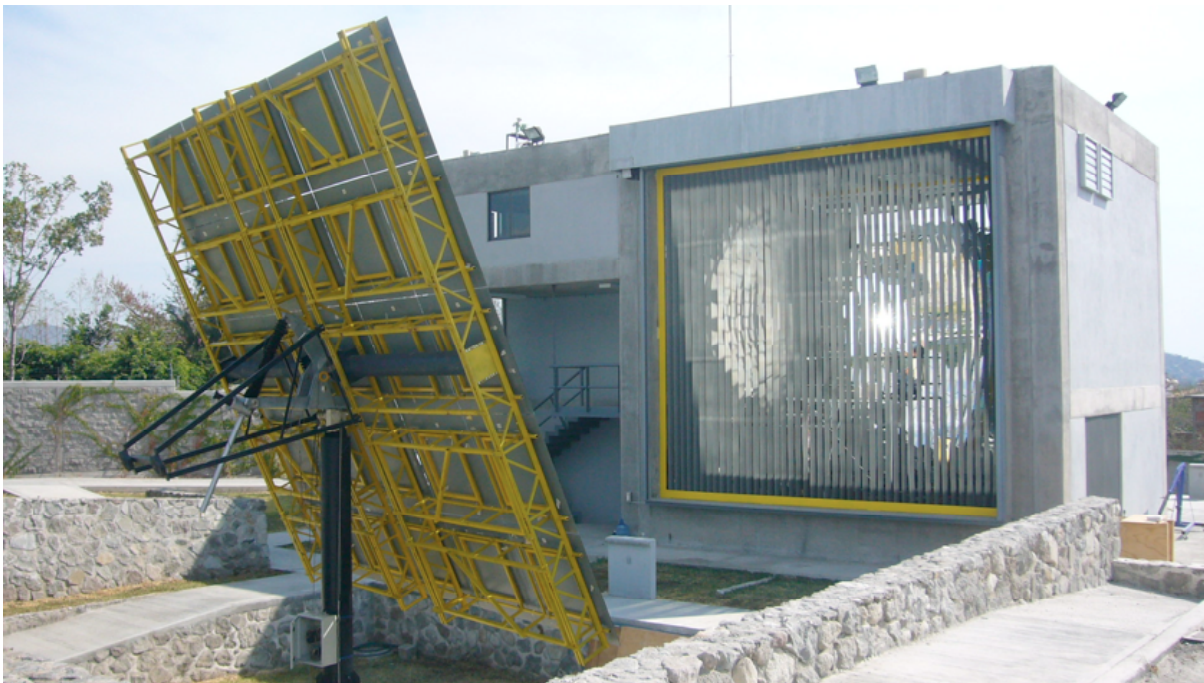
Fig. 1. Vista exterior del HSAFR donde se aprecia el helióstato, el atenuador y el concentrador.
