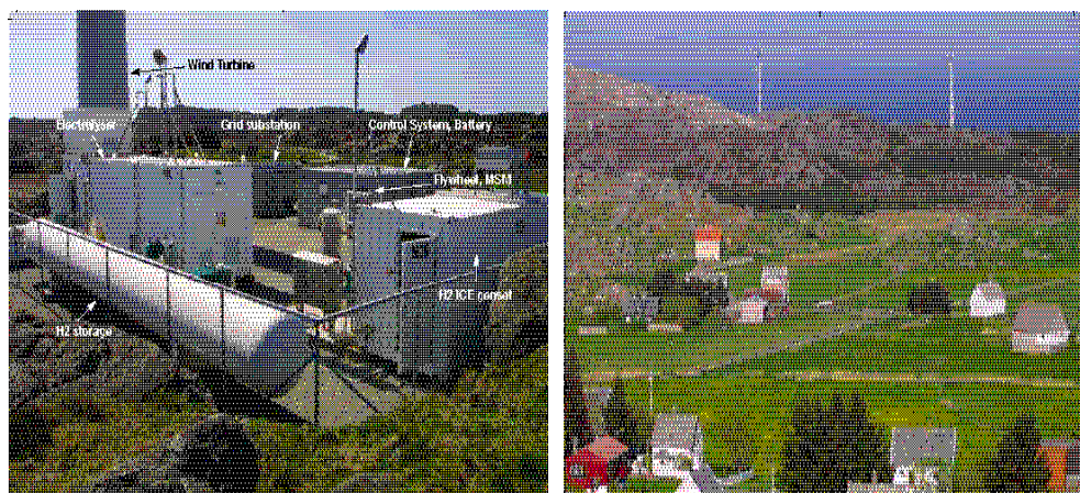
Fig.1. Sistema eólico/hidrógeno instalado en Utsira, Noruega.
