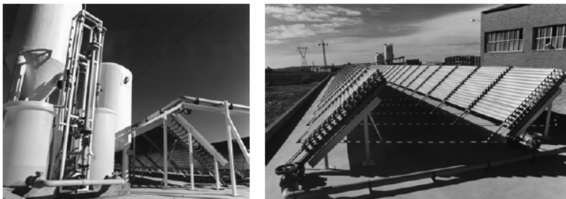
Figura 1. Planta de Detoxificación Solar. HIDROCEN S.L
