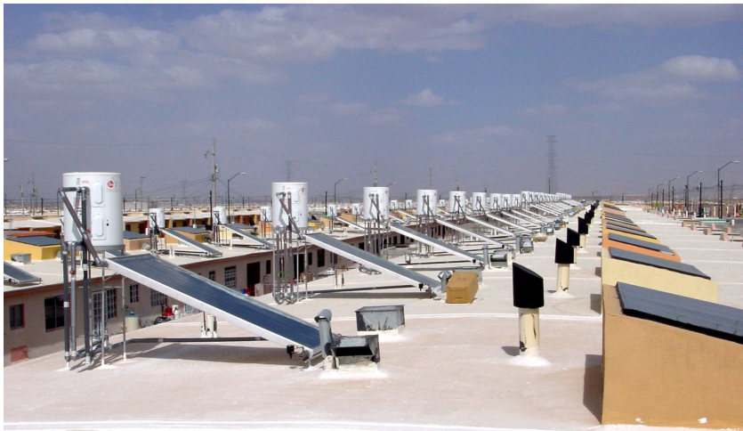
Figura 9. Instalación de calentadores solares planos en una unidad habitacional en Ciudad Juárez, Chihuahua. Foto cortesía de Sunway, S.A.
